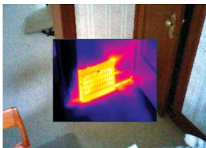
图 5-4. 在该 HVAC 通风装置的画中画 (PIP) 热图像中，浅色束状热图案指示管道系统连接的漏气量超标。
