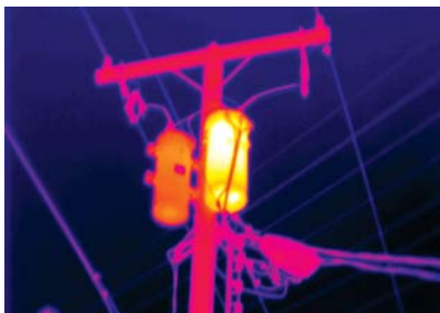
图 5-84. 该热图像指示右侧的变压器可能存在内部故障。
