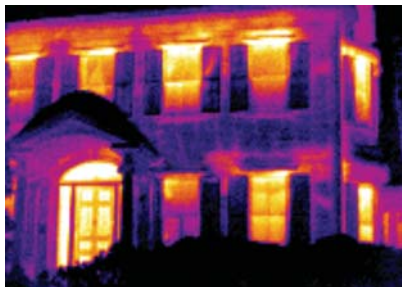
图 5-49. 在寒冷天气中,与建筑物外部相比,缺少保温材料的区域会显示成温点。
