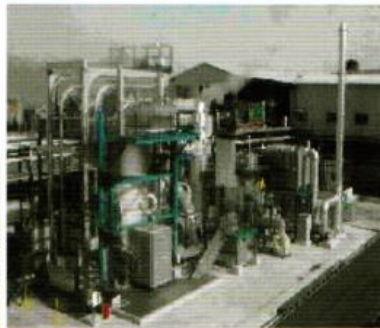
30m 3 燃烧炉、处理量3ton/day
