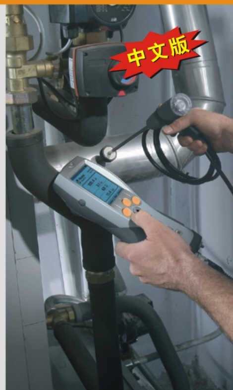
燃气锅炉的烟气分析
